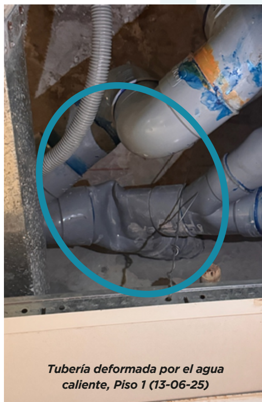
Goteo de agua - Duchas Piso 1 - 13-06-25 (constantes en toda la obra)
